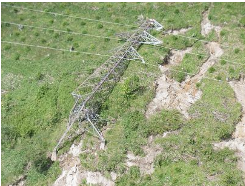
地崩れにより倒壊した送電鉄塔（むかわ町）
